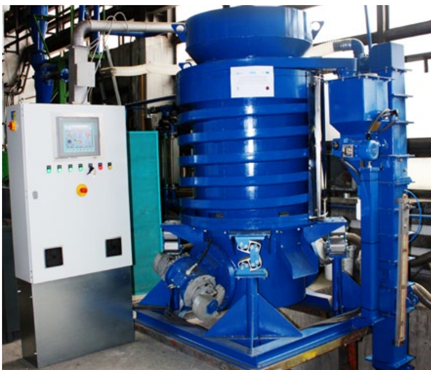
Rys. 2. Widok regeneratora REGMAS zainstalowanego w hali maszyn odlewniczych Wydziału Odlewnictwa AGH
