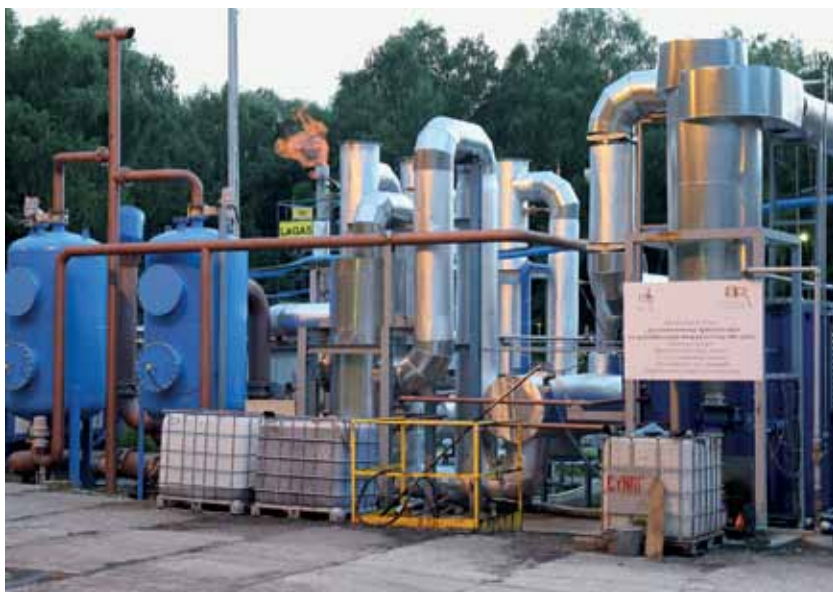
Fragment części naziemnej pilotowej instalacji GIG do KWK Wieczorek.
