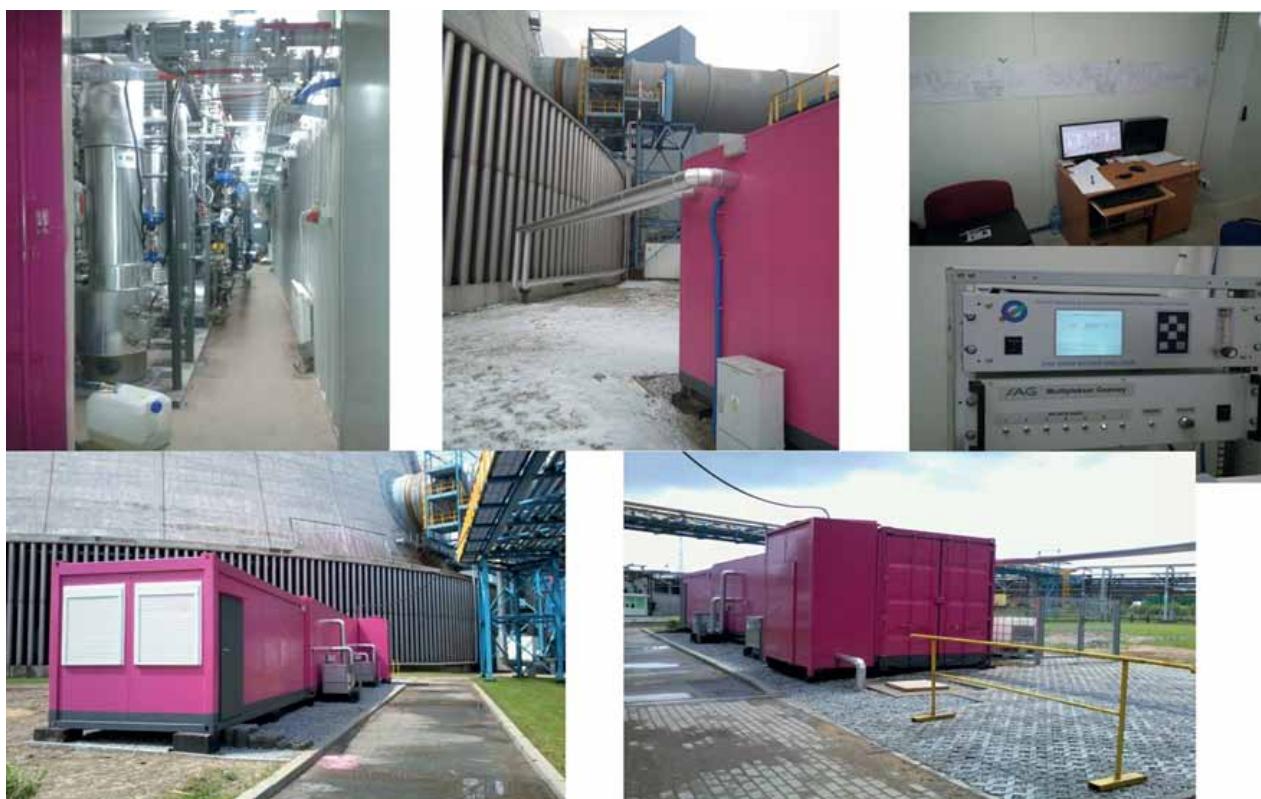
Instalacja mobilna do wychwytemu CO 2 metodą adsorpcyjną VPSA w Tauron Wytwarzanie Elekrownia Łągisza SA
