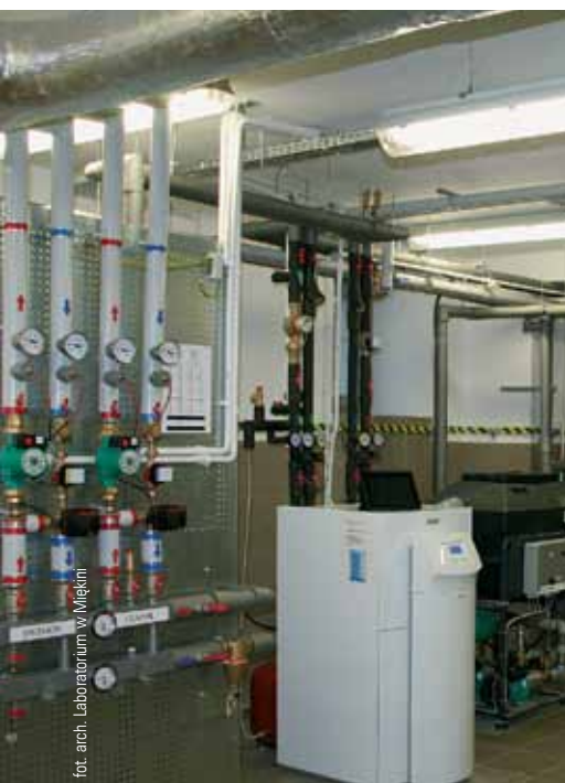
Kotłownia z pompami ciepła w Laboratorium w Miękinii.
