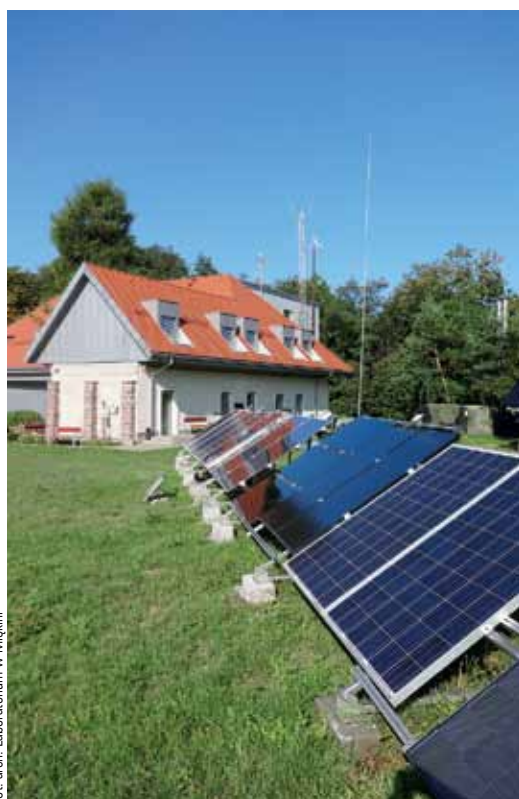
Instalacja badawcza modułów fotowoltaicznych I i II generacji.
