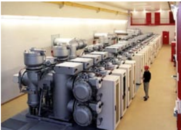
Rys. 13. Widok rozdzielni gazowej
